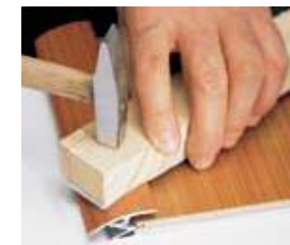
aplicar o perfil sob pressão, com um maço de madeira ou borracha, de modo a alinhar o topo do perfil com a superfície do pavimento
